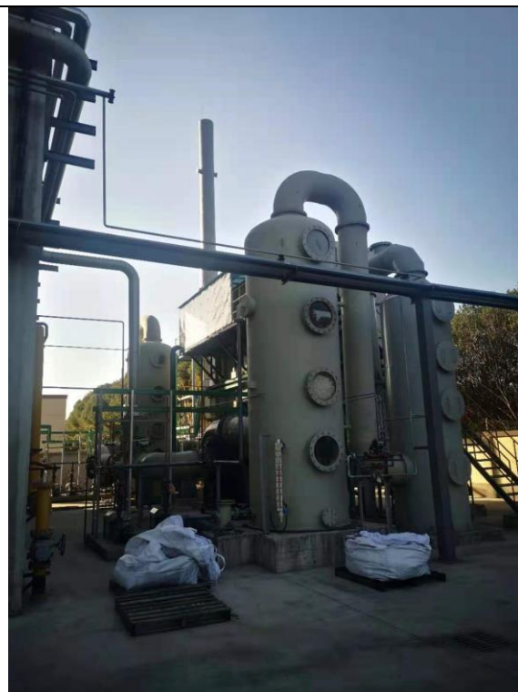
14#RTO处理装置
