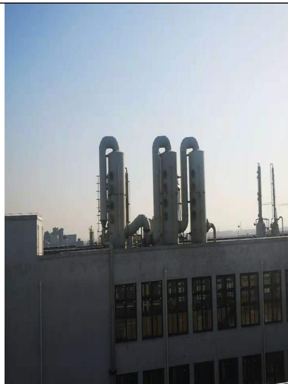
F车间12#、13#废气处理装置
