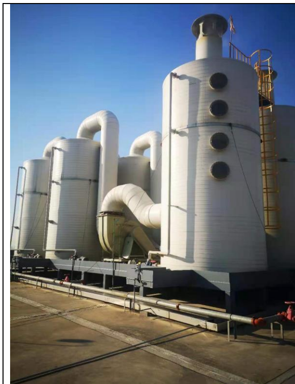
10#、11#废气处理装置
